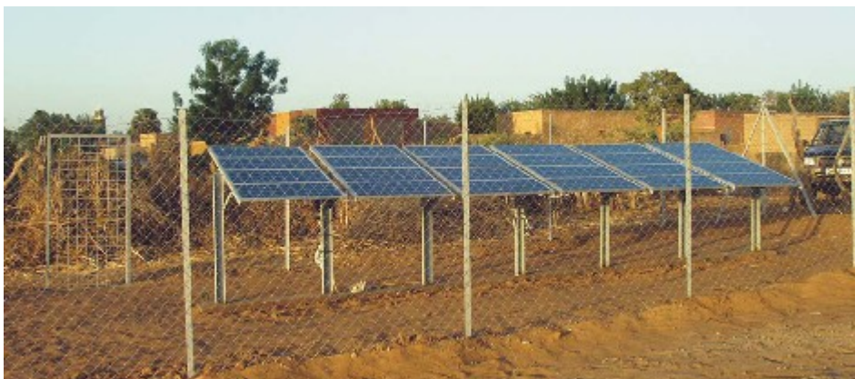
La production d'eau par pompage solaire a débuté effectivement
